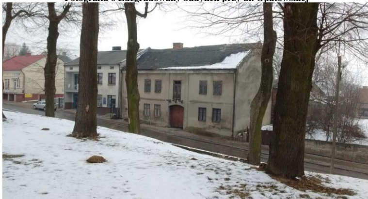
Fotografia 6 Zdegradowany budynek przy ul. Opatowskiej
